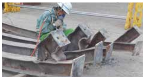
圧力に耐えきれず変形した鋼製支保工
