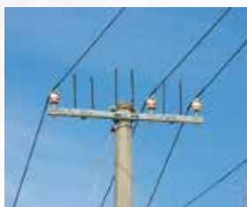
電柱に止まらないよう、突起をつけたものもある。
